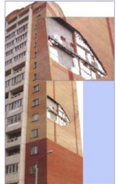
Рисунок 6. Обрушение фасада дома вследствие коррозии стальных гибких связей
